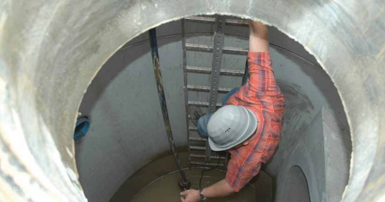
Staukanal Regenwassermanagement 'Helix® Compacta' Sachsenheim Fassungsvermögen 75 m 3
